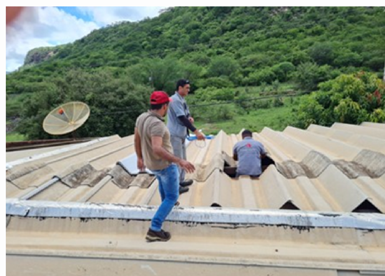
Registros fotográficos do telhado da residência feminina UAST, após as chuvas de dezembro/2023 (Acervo da PROGESTI).
