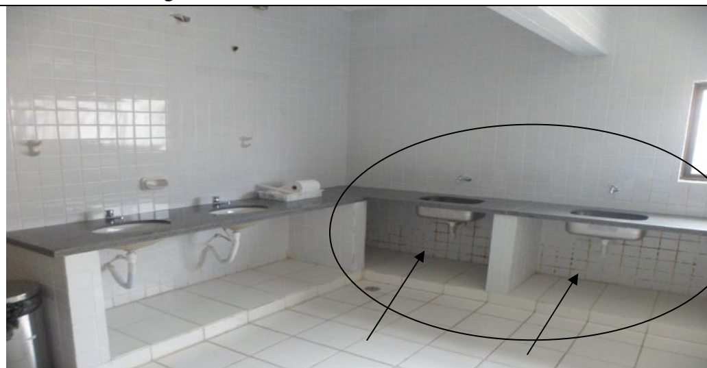
Bolor em rejunte de revestimento de paredes, evidenciando problemas de umidade, em salas de aulas práticas nas quais há manuseio de gêneros alimentícios, o que pode comprometer a segurança dos alimentos.
