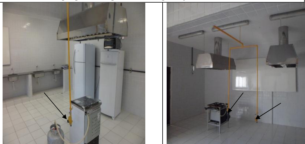
Ausência de instalação de fogões em sistema de gás encanado, apesar de as coifas já estarem instaladas
