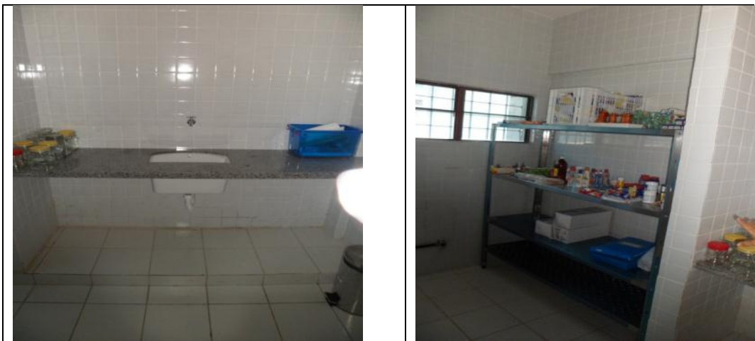
Ausência de ralo no piso da lavanderia
