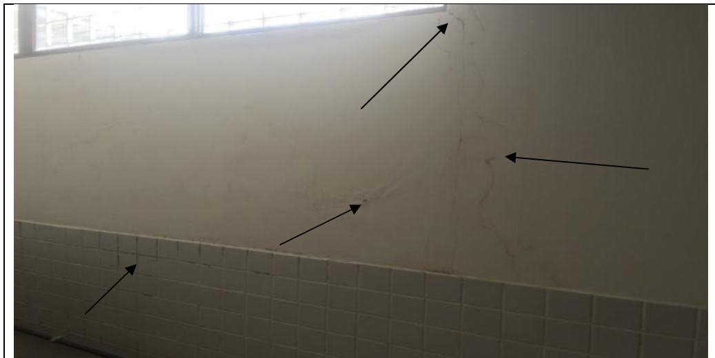
Infiltrações que afetaram o revestimento e a pintura em paredes
