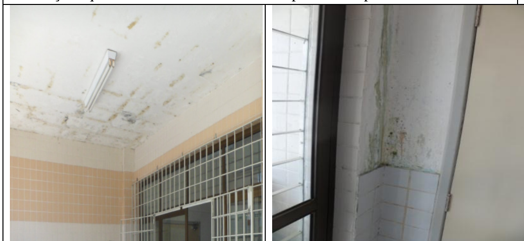
Infiltrações em teto e parede
